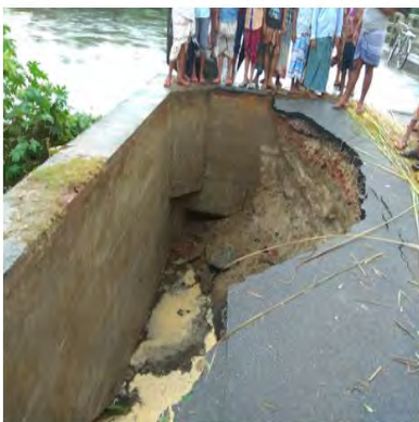
6. m) Collapsed road
